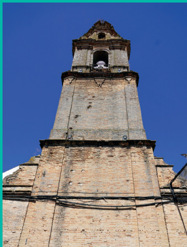
Impacto de ametralladora pesada en la frontal de ladrillo de la torre de San Francisco. Foto AACarazo
